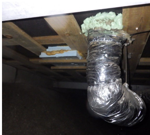
Kuva 9, Rakenneavauksen tulppaus. Läpivientien eristykset ovat epätiivit
