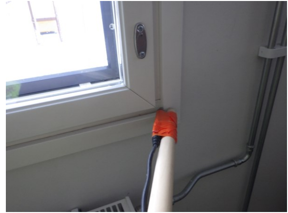
Kuva 39, Ikkunan ja ulkoseinän välisessä liittymässä merkittävä ilmavuoto
