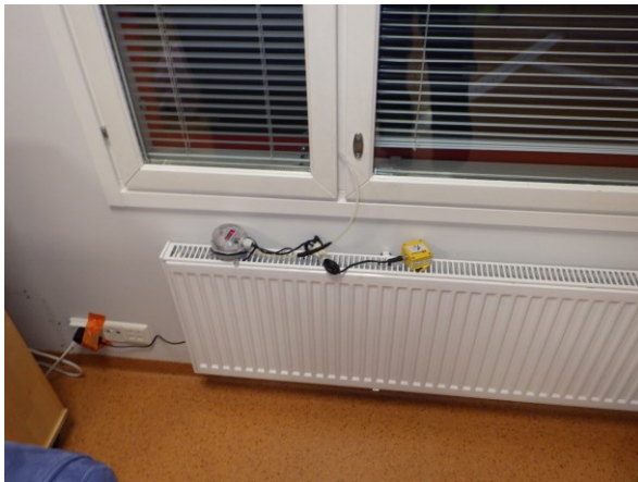
Kuva 60, Tallentava paine-eromittaus asennettuna toimintaan Lepohuoneessa 117
