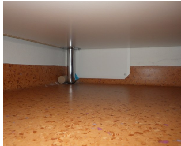
Kuva 50, Merkittävä ilmavuoto tutkimusluukun läheisyydessä
