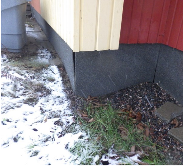
Kuva 2, Sokkelilevyt ovat paikoin irti rungosta
