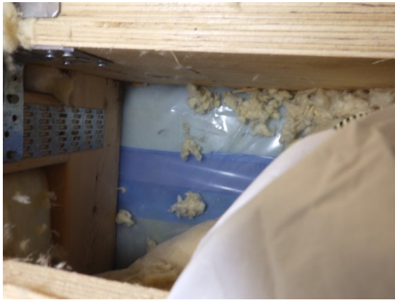
Kuva 19, Höyrinsulkukalvojen jatkokset on ainoastaan limitetty, tiivistysteippaukset puuttuvat
