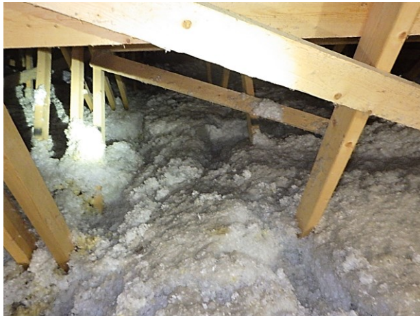
Kuva 21, Yläpohjan eristetilassa on liikuttu ja eristeessä on painaumuksia
