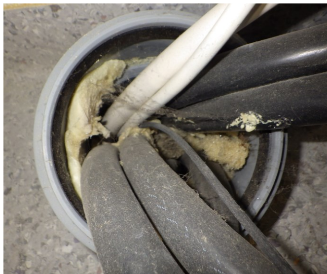
Kuva 13, Kaapeliläpivientien uretaanitiivistykset ovat epätiivit
