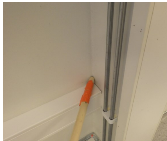
Kuva 37, MA1 ilmavuoto seinäkoteloinnissa
