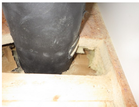
Kuva 57, Ilmansulkupaperin ja läpivientiputken väliä ei ole tiivistetty
