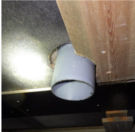
Kuva 10, Tiivistämätön läpivienti alapohjassa, mahdollinen AP tuuletusputki
