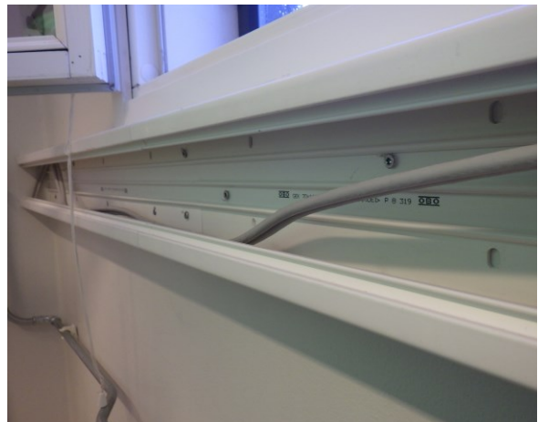
Kuva 41, Ilmavuotoja kaapelikourun kiinnikeruuvien alueella
