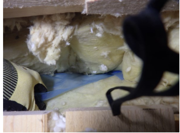
Kuva 18, Höyrinsulkukalvon jatkoksia ei ole moduulilinjan kohdalla teipattu tiiviiksi
