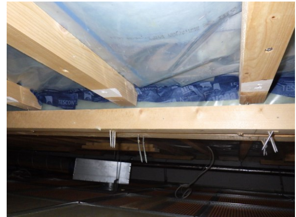
Kuva 20, Aistinvaraisesti epätiivit ilman-sulkukalvon teippaukset. Epätiiveys etenkin höyrinsulussa olevien taitteiden alueilla.
