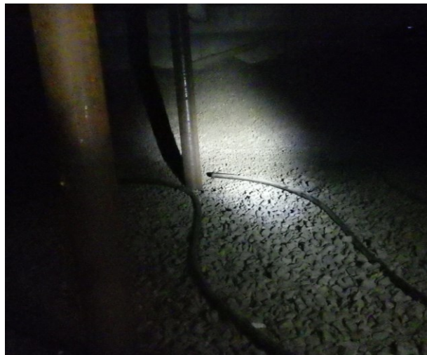
Kuva 7, Tunnistamaton sähkökaapeli tulee maan alta
