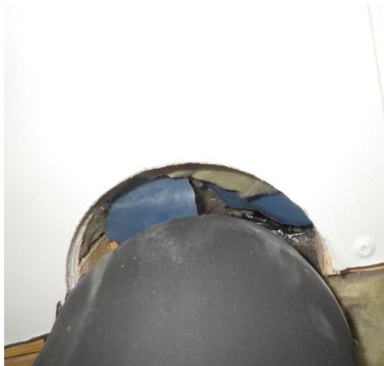
Kuva 25, Yläpohjan höyrynsulkukalvoa ei ole tiivistetty asianmukaisesti läpivientiputkeen
