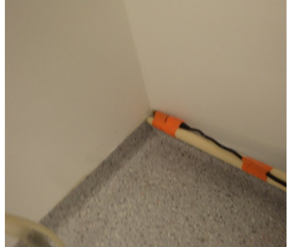
Kuva 35, MA1 merkittävä ilmavuoto nurkassa
