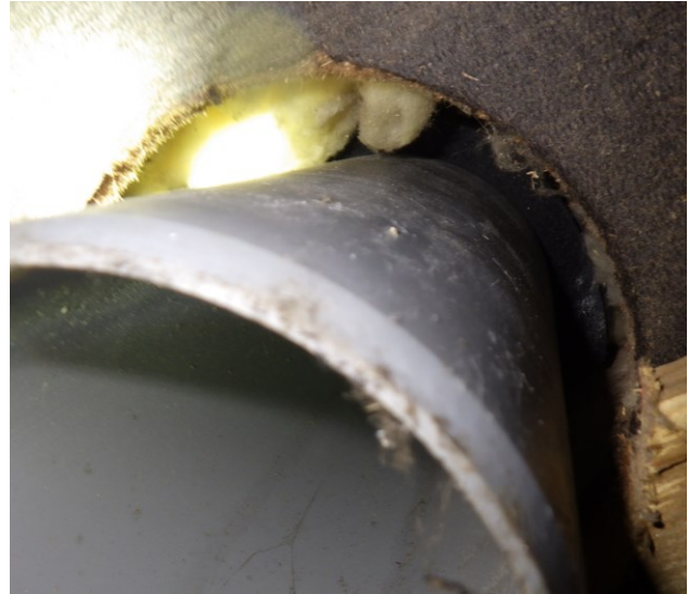
Kuva 11, Tiivistämätön läpivienti alapohjassa, villa eristys on irti putkesta ja tuulensuojalevyn liittymä on tiivistämättä
