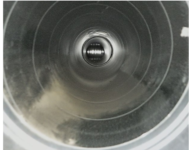
Kuva 28, Lepohuoneen 117 IV-kanavan pölynkertymä. Kuvassa vertailupinta näkyy puhdistettuna putken oikeassa alareunassa
