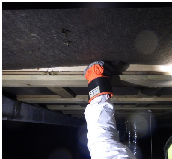
Kuva 8, Tuulensuojalevyt ovat heikosti kiinni tukirakenteessa eikä niiden saumoja ole teipattu tiiviiksi
