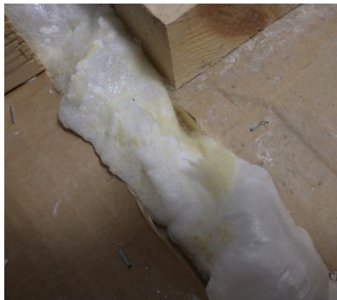
Kuva 53, Uretaani eristys on pursunnut raosta hal- litsemattomasti vapaaseen tilaan
