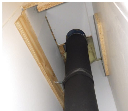
Kuva 24, Yläpohjan läpiviennistä puuttuu sisäverhouslevy ja eriste on näkyvissä
