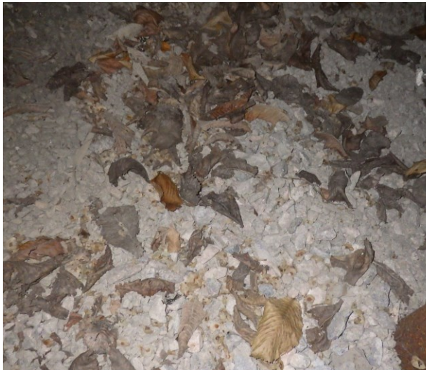
Kuva 4, Orgaanista materiaalia alapohjassa
