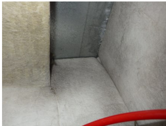
Kuva 32, Tuloilmakotelin eristeitä puuttuu ja levyt ovat tummuneet
