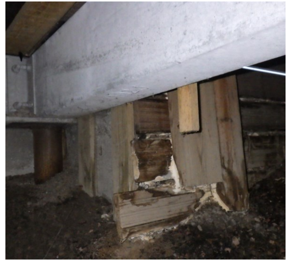
Kuva 5, Mikrobivaurio sokkelin laudoituksessa
