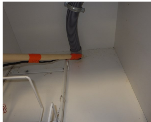
Kuva 48, Ilmavuoto allaskaapin viemäriäpiviennin läheisyydessä
