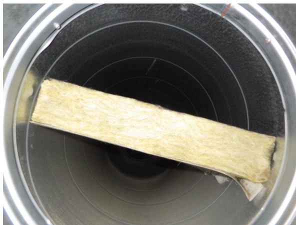
Kuva 29, Tuloilmakanavassa ollut villalevy
