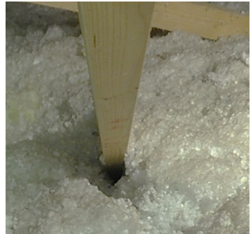
Kuva 22, Kattoristikon alapuolella olevaan eristetilään syntynyt ilmakehä
