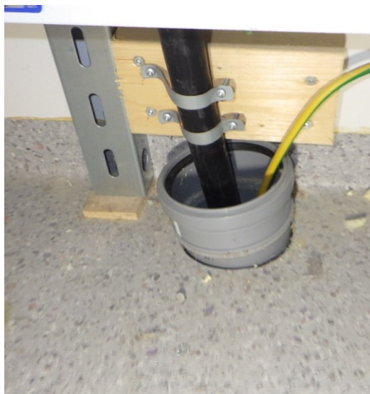
Kuva 12, Kaapeliläpivientien kautta on voimakas ilmavirtaus huoneilmaan
