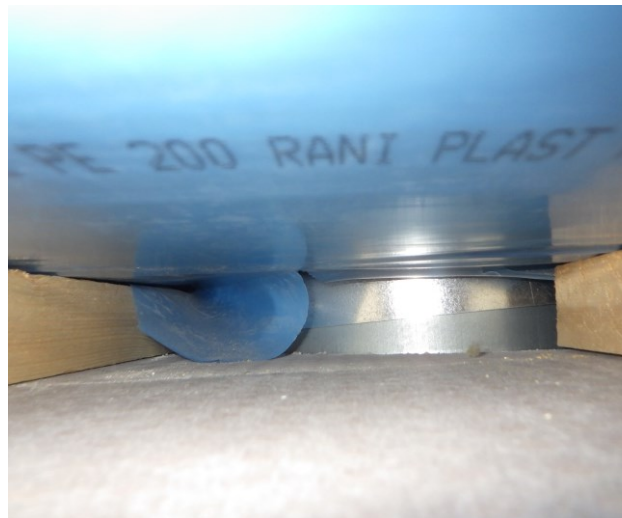
Kuva 26, IV-kanavan ja höyrynsulkukalvon liitoksesta puuttuu rakenteen tiivistävä läpivientikappale ja liitos on todella epätiivis
