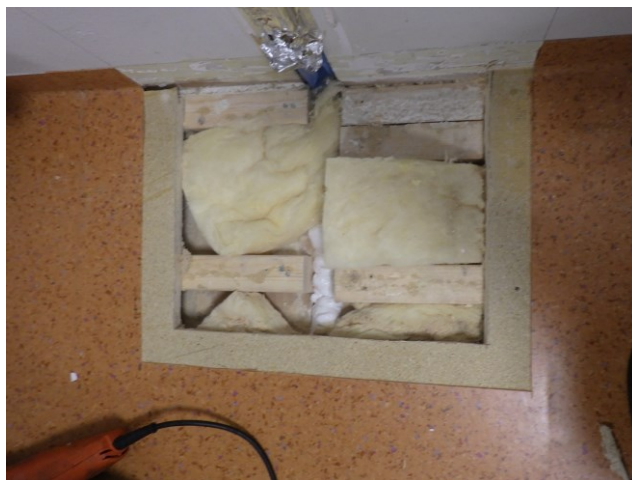
Kuva 51, Eristevilloja ei ole asennettu rakenteeseen tiiviisti
