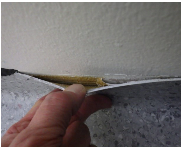
Kuva 36, Epätiivis lattiamaton liitos
