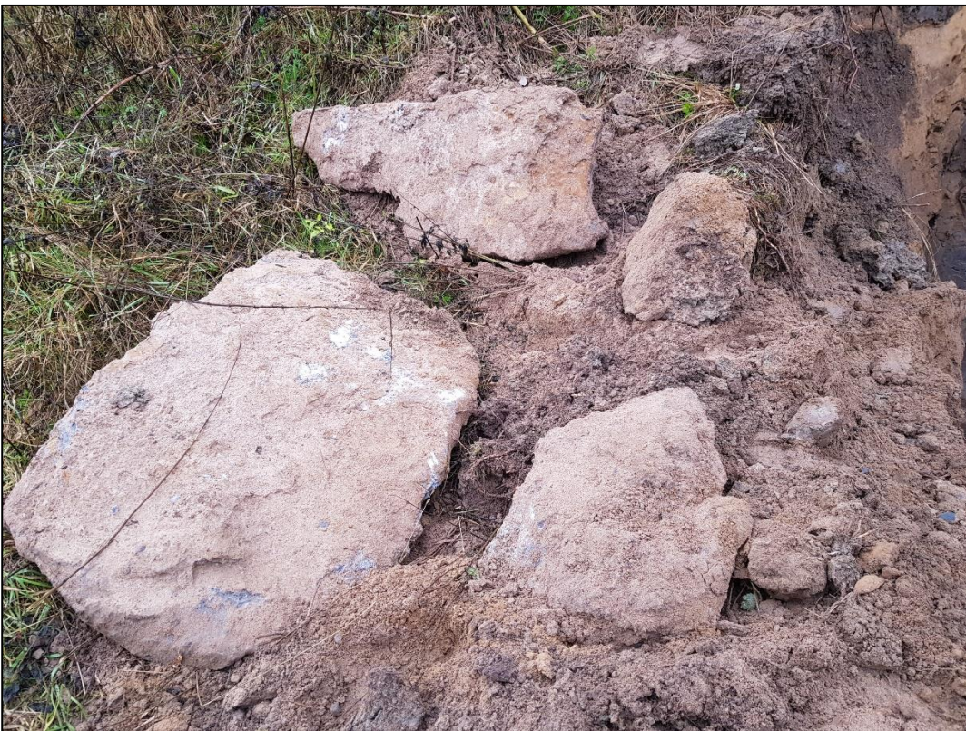
Kuva 2. Koekuopassa SE4 havaittuja betonikappaleita.
